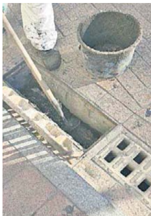
Esta medida evitará problemas de inundaciones.
